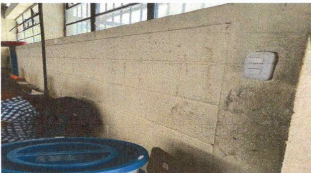
Foto11: Pintura en mal estado (interior)
