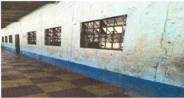
Foto 9: Pintura en mal estado (exterior)
