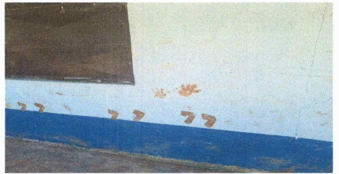
Foto 8: Pintura en mal estado
