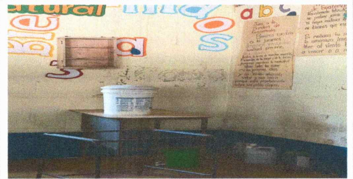
Foto 12: Pintura en mal estado (interior)
