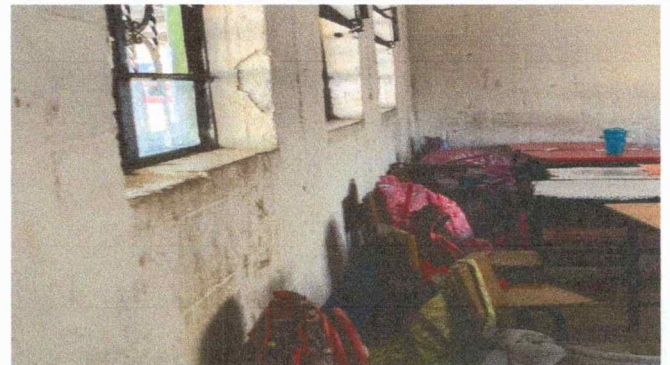
Foto 10: Pintura en mal estado (interior)
